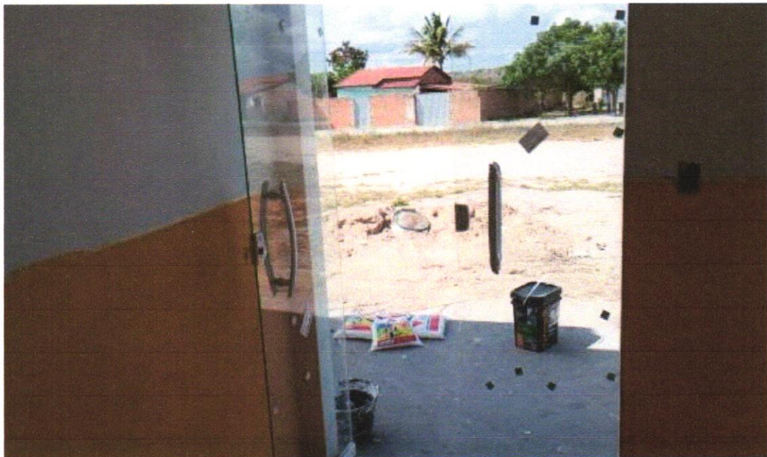
FOTO 28 - Porta em vidro temperado 10mm, incolor, inclusive ferragens de fixação e instalação, exclusive puxador - Rev 01_10/2021
