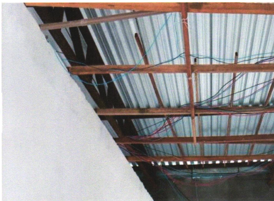
FOTO 05 - CABO DE COBRE FLEXÍVEL ISOLADO, 4 MM 2 , ANTI-CHAMA 450/750 V, PARA CIRCUITOS TERMINAIS - FORNECIMENTO E INSTALAÇÃO. AF_12/2015
